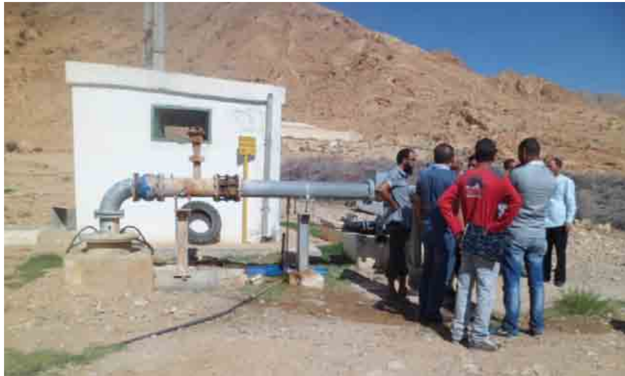
Pompage d'eaux d'irrigation à El Guettar
